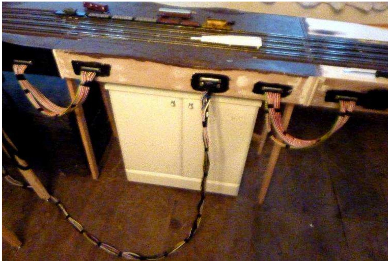
Propojovací kabely mezi moduly 4/1, 4/2 a 4/3 a tlustoučký kabelový svazek od ovládacího panelu do modulu 4/2.
